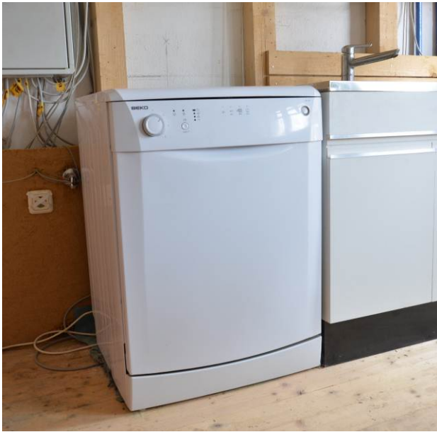
Abbildung 90: Geschirrspüler mit Warmwasseranschluss im Küchenbereich
