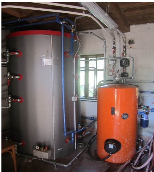
Abbildung 89: Hygiene-Kombispeicher (1500 l) und Speicher (200 l) im Prototypengebäude in Böheimkirchen
