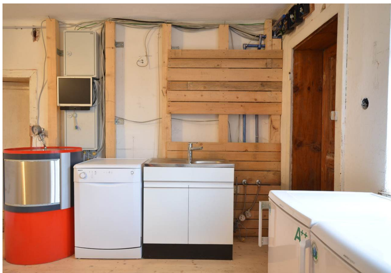
Abbildung 98: Küchenbereich mit thermisch und elektrisch betriebenen Endgeräten inklusive Zero CO 2 Cooler (ganz links)
