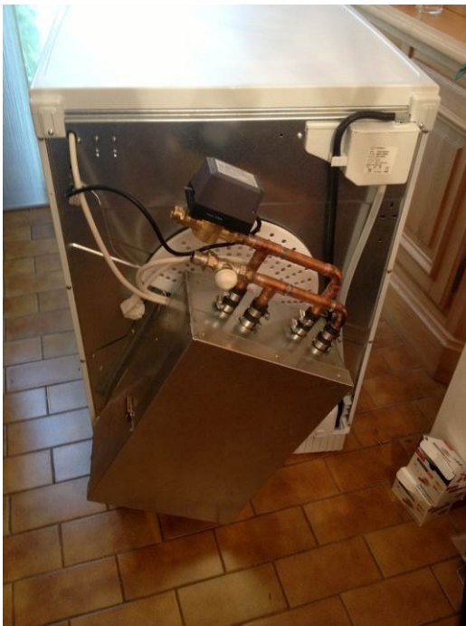
Abbildung 92: Auf der Rückseite des thermischen Wäschetrockners ist der Wärmetauscher sichtbar
